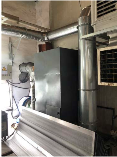
图 4-2 本项目主要废气治理设施（焊接废气处理设施）
